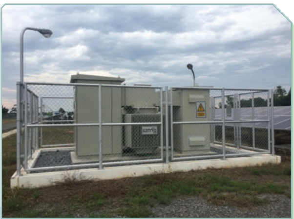
หม้อแปลงไฟฟ้า (Transformer)
